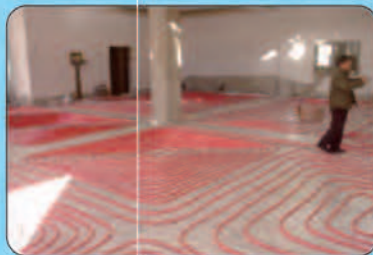
西藏拉萨市委食堂太阳能集热水电采暖项目
